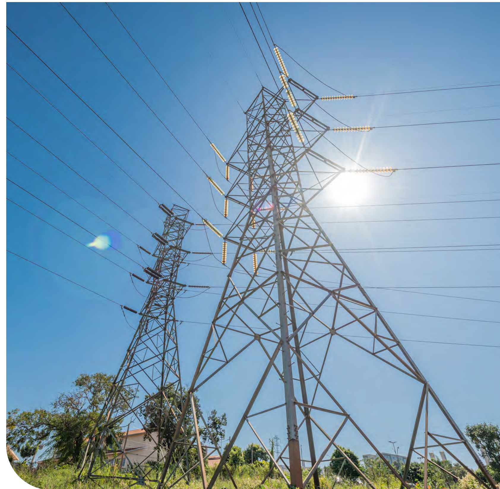
Torres de subtransmissão em Araraquara (SP).
