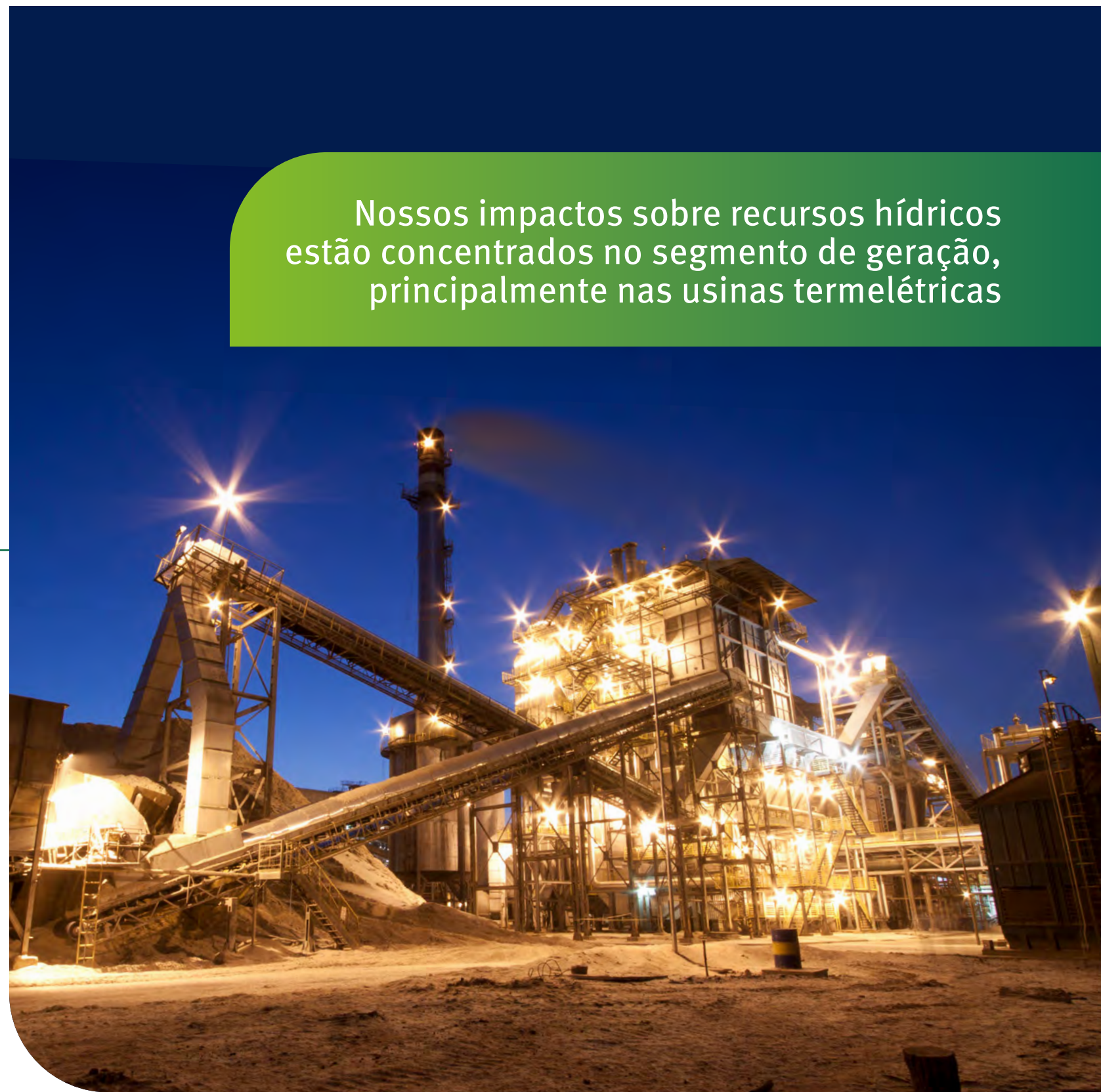
Usina de biomassa em Pirassununga (SP).
