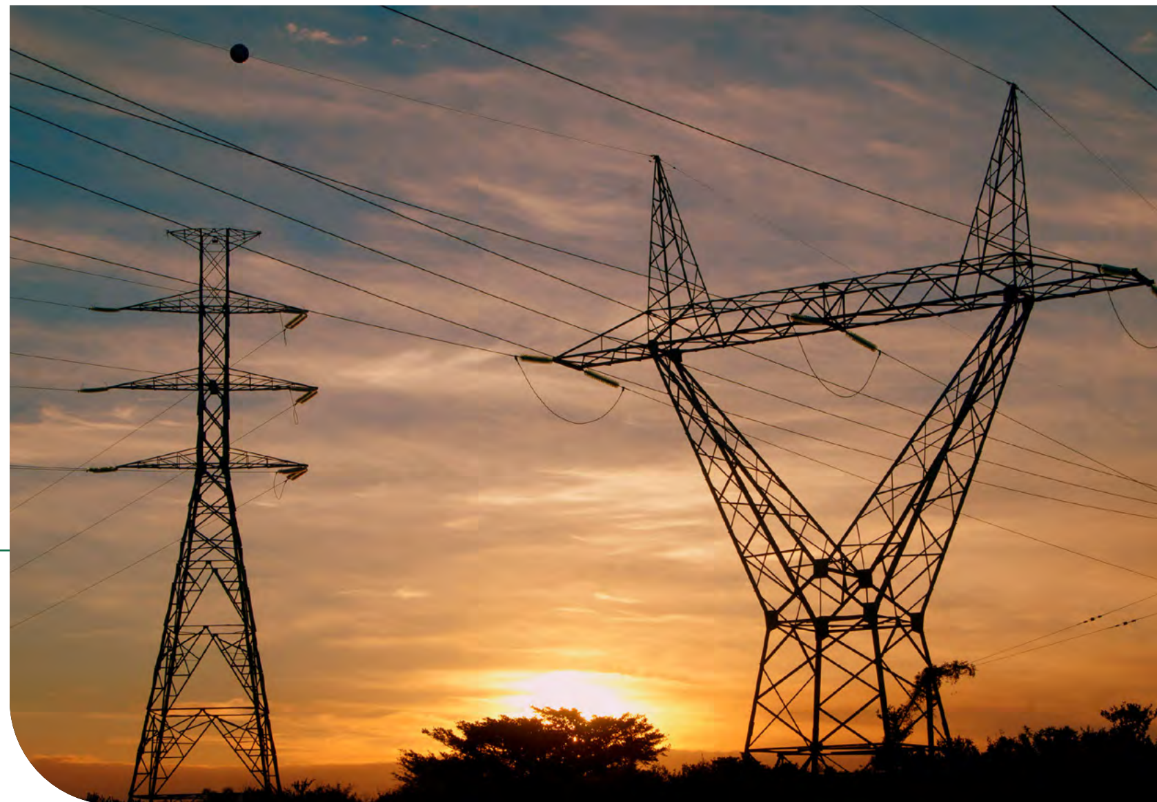
Linha de transmissão em Rio Grande (RS).
