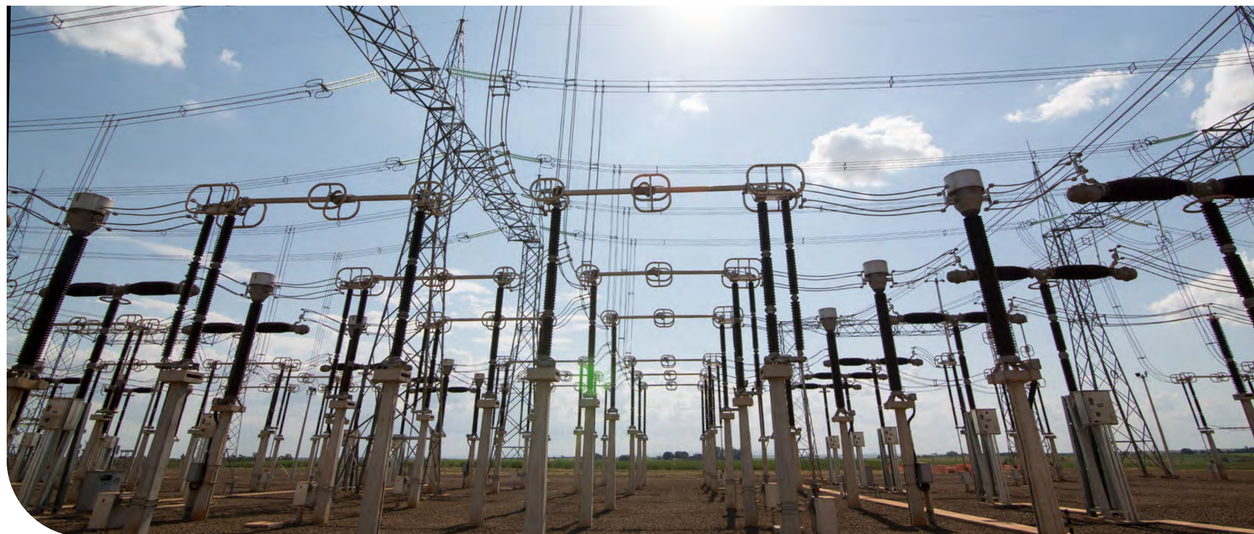
Subestação Piracicaba, em São Paulo.
