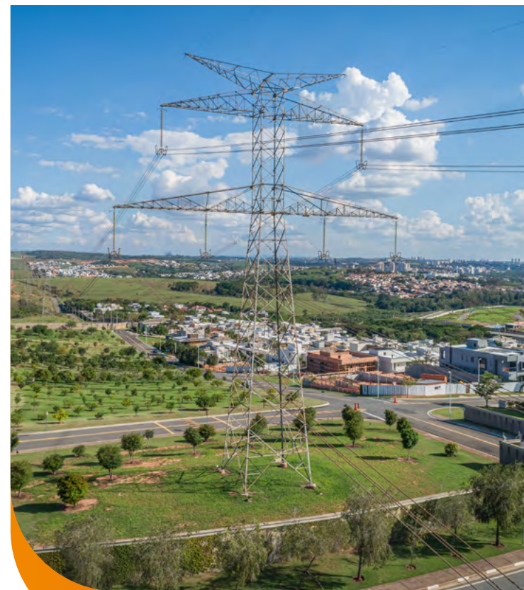
Torre de transmissão Campinas - SP
