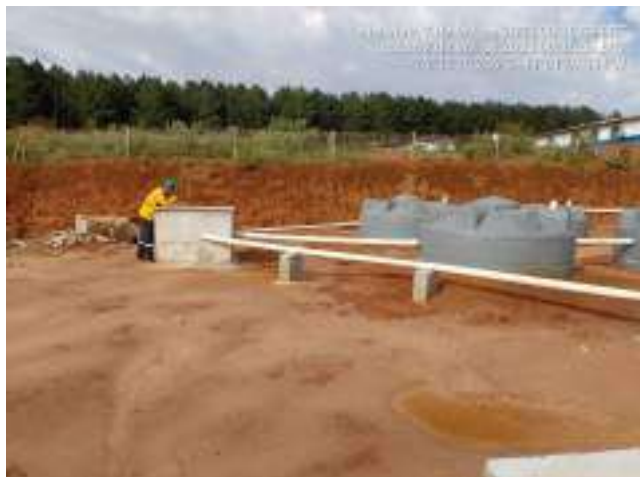
Figura 05 – Estação de Tratamento de Efluentes
