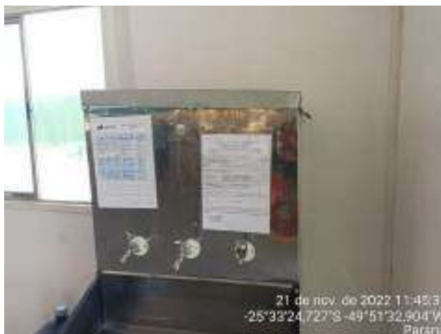
Figura 10 – Laudo e controle de limpeza dos bebedouros
