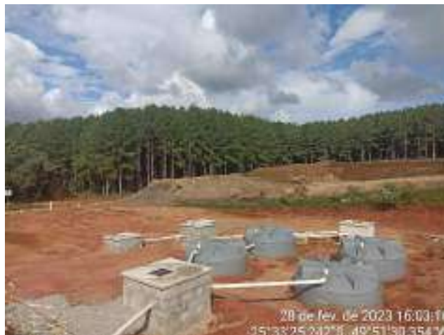
Figura 06 – Estação de Tratamento de Efluentes
