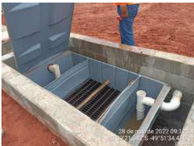
Figura 05 – Caixa SÃO oficina
