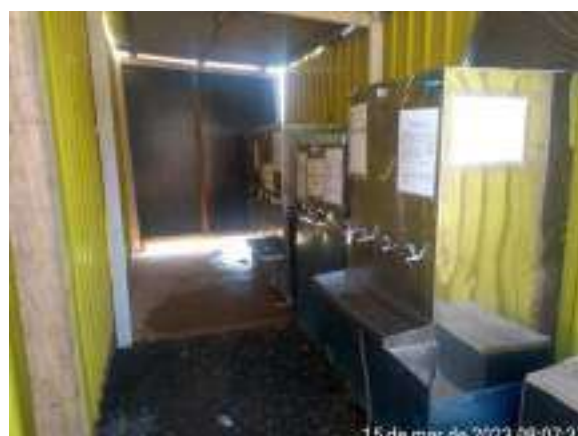
Figura 22 – Bebedouros disponibilizados com laudo e controle
