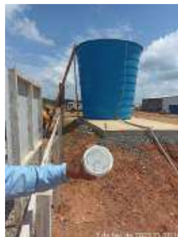
Figura 16 – Clorificação da água com Clorin
