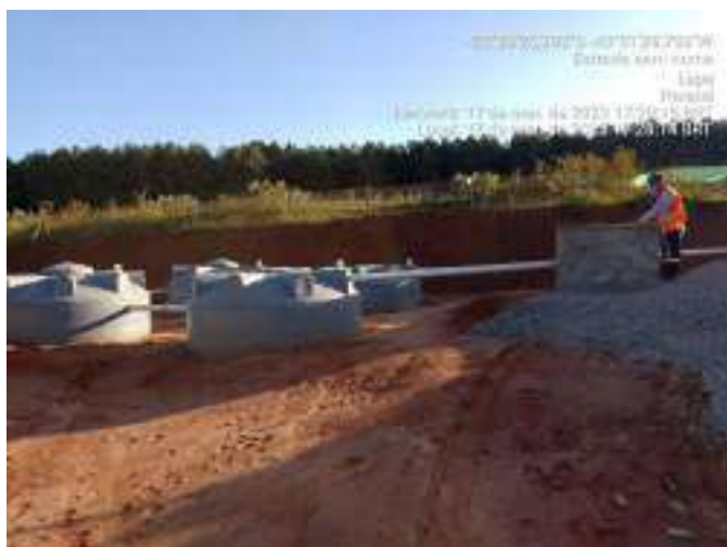
Figura 11 – Estação de Tratamento de Efluentes
