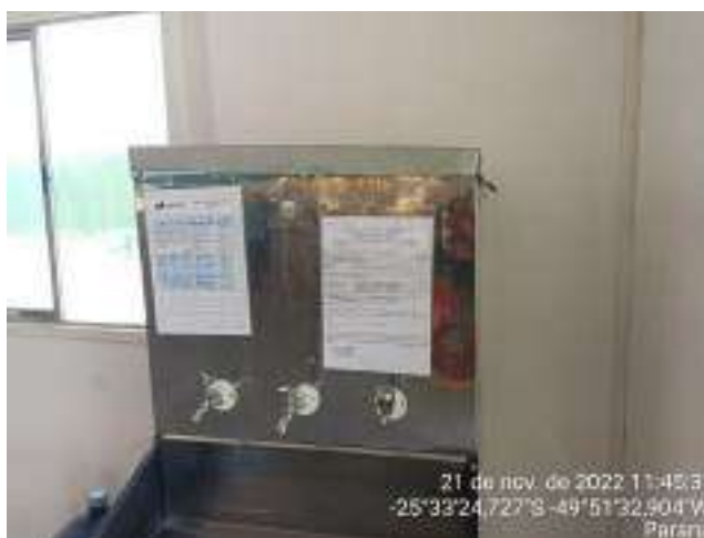
Figura 14 – Laudo e controle de limpeza dos bebedouros
