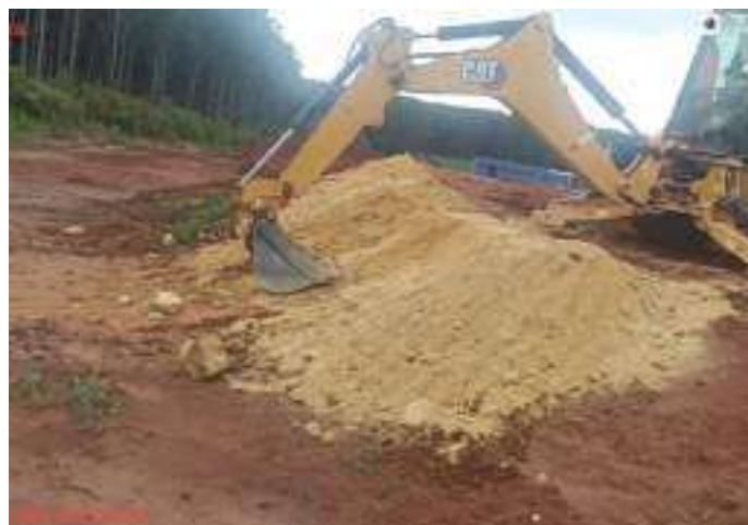
Figura 16 – Medida corretiva de erosão
