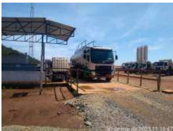
Figura 41 – Abastecimento de diesel - tanque de combustível
