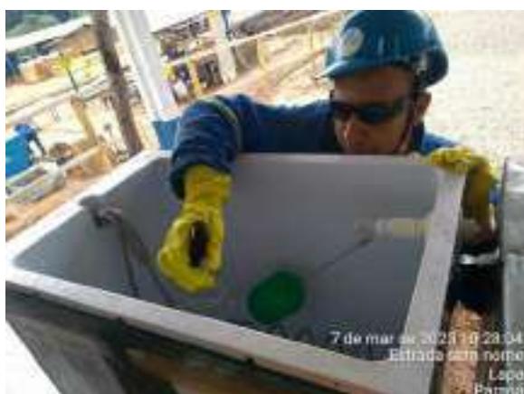
Figura 21 – Limpeza e lacre dos bebedouros
