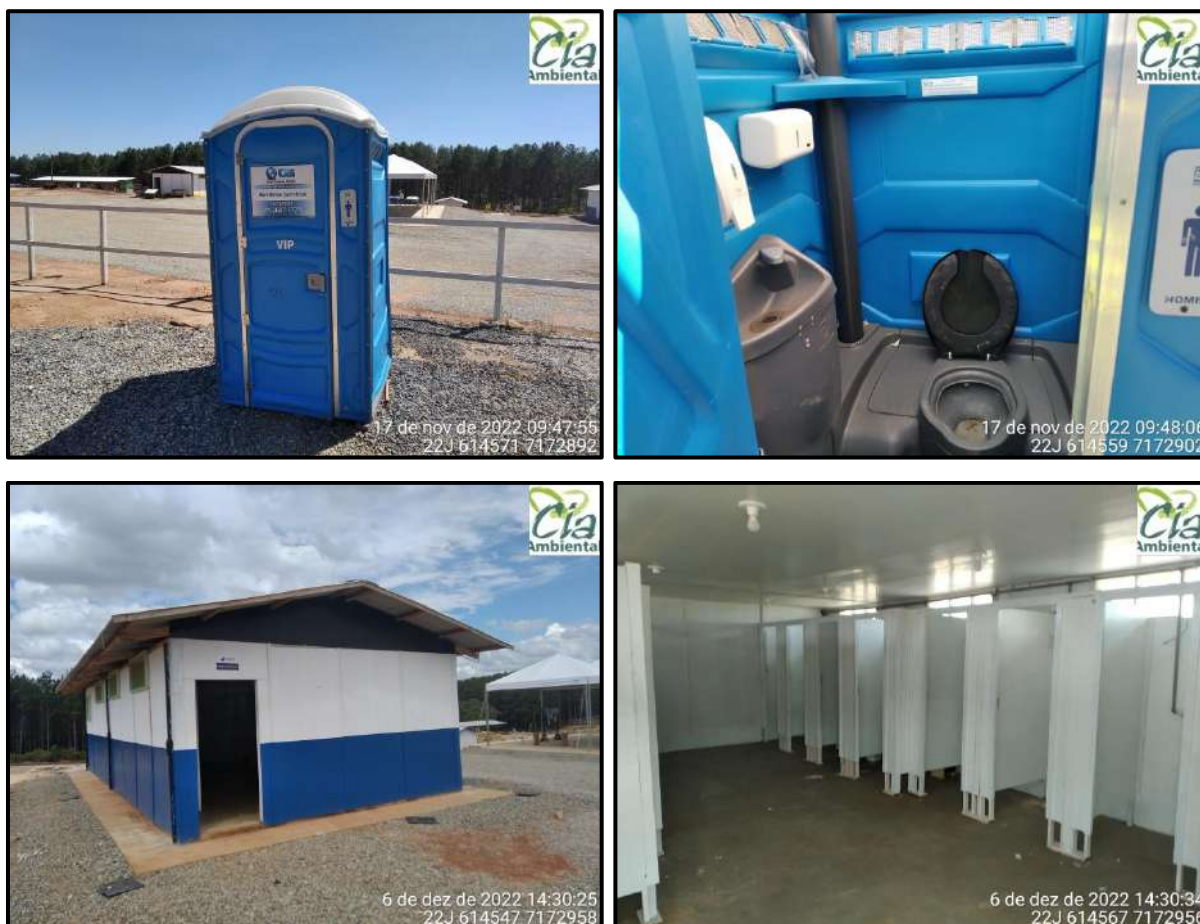
Figura 16 - Registros fotográficos das inspeções realizadas nos banheiros químicos e vestiários instalados no empreendimento.
