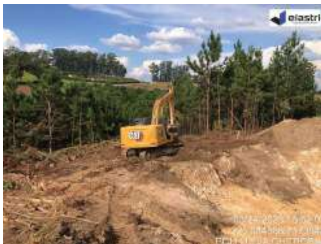
Figura 53 – Retirada de expurgo
