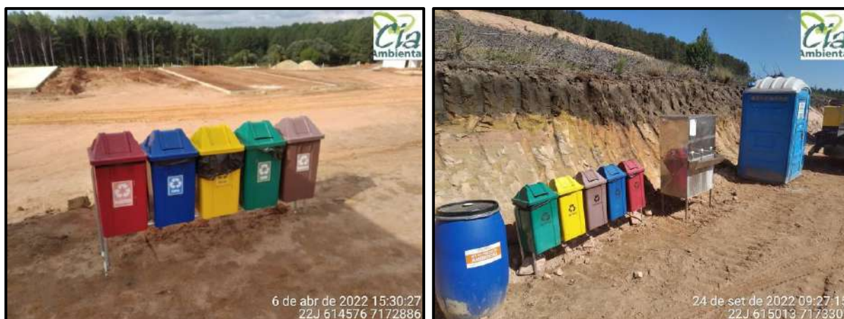
Figura 6 – Coletores de resíduos instalados na PCH Cherobim.
