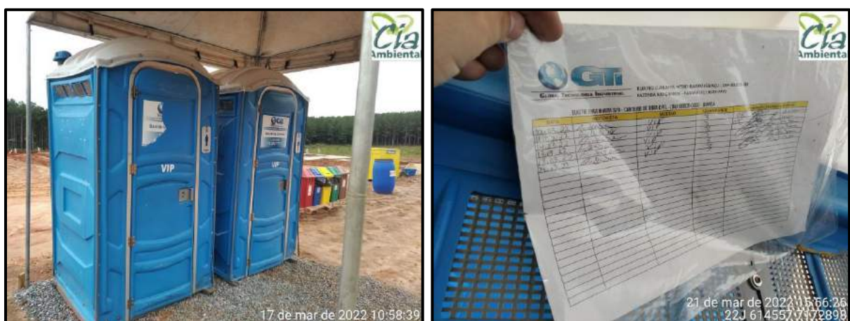
Figura 6 – Banheiros químicos instalados e respectiva ficha de controle de limpeza.
